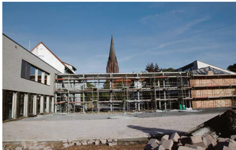
Mit einem Glasgang wird in den nächsten Wochen der Umbau der Wieschhof-Grundschule weitgehend abgeschlossen.
